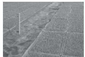
写真3 温度計の設置状況
